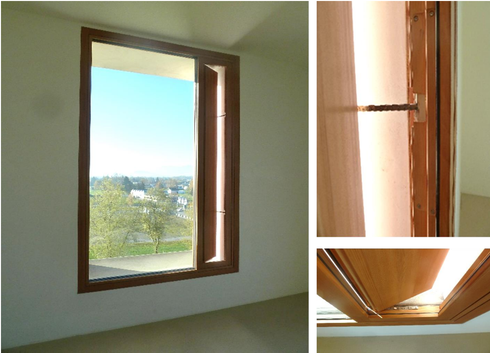
Figur 4: Lufteluker i 2226-bygget i Lustenau. Motorer er kjettingsmotorer integrert i karmen på vinduene.
